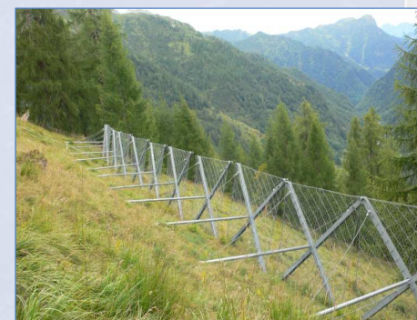
Dettaglio filare elementi "VELA-Fermaneve"
